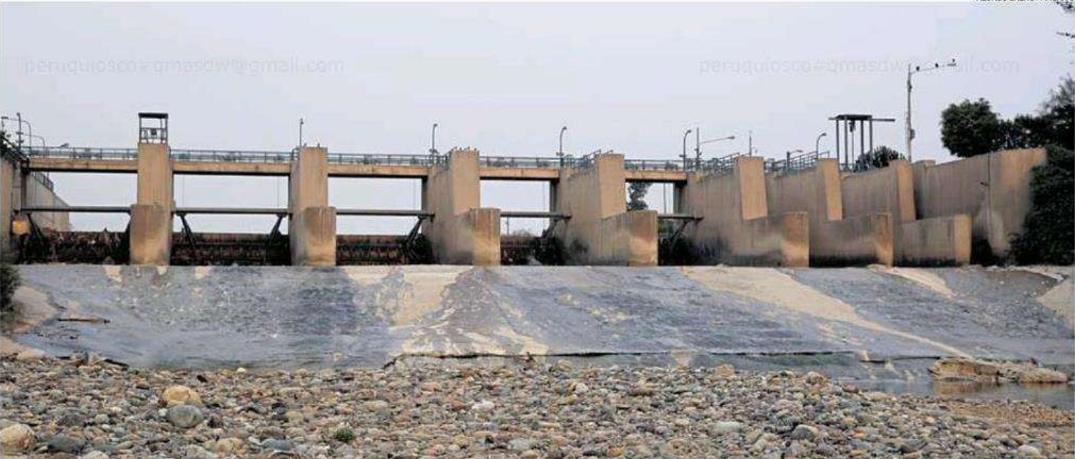
La planta de tratamiento La Atarjea abastece al 70% de Lima Metropolitana y depende del caudal del río Rímac. En la foto se observa el estado de la planta ante la falta de lluvias del 2016.
