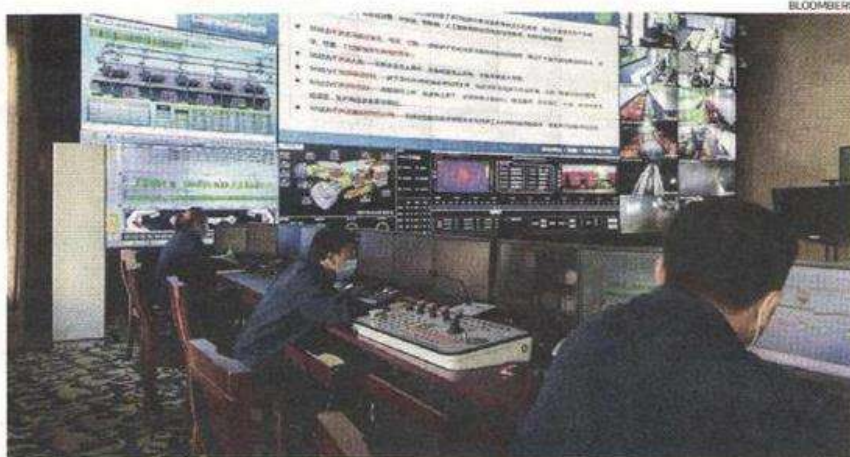
La adopción de tecnologías permite optimizar operaciones y mejorar la eficiencia.
